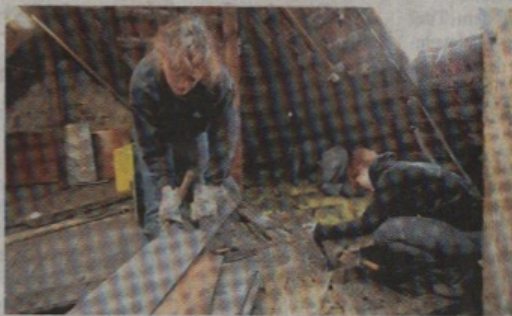
Die Dämmung des Dachbodens war am Samstag die Aufgabe des Vereins „Abenteuer helfen“.
